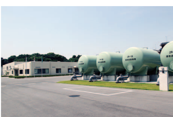
ありあけ浄水場 福岡県大牟田市企業局／熊本県荒尾市 水道局共同発注のDBO案件。メタウォーターが代表企業として受注
